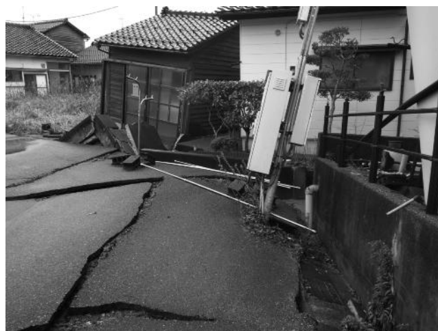
液状化による被害
