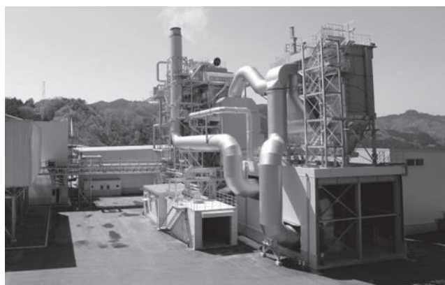
(真庭バイオマス発電所)
