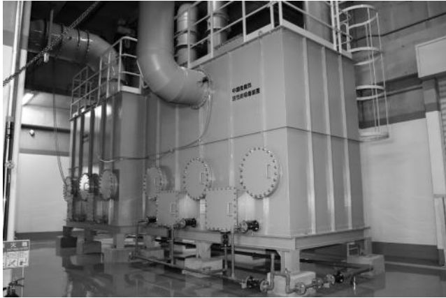
写真 (2) 【活性炭吸着装置】
