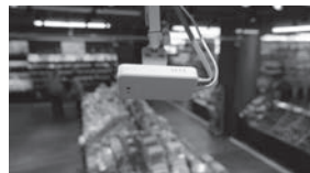
店舗内の天井に設置されたAIカメラ
