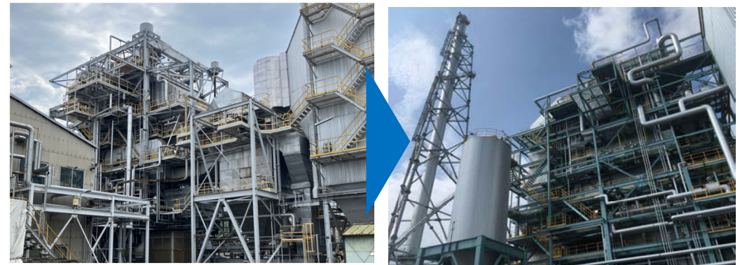
(既存)讃岐工場 石炭発電設備
