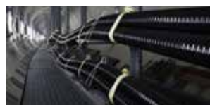
▲ 地内系統(地下トンネル内部) (出典: 東京電力ホールディングス株式会社)
