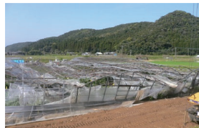
[園芸施設共済] 風害による園芸施設の被害
