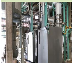
高効率ボイラー (タイ)
