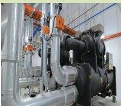
高効率冷却装置 (ベトナム)
