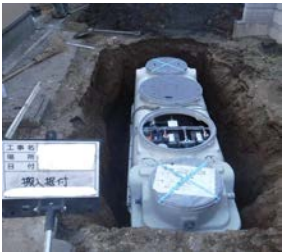
【合併処理浄化槽】
