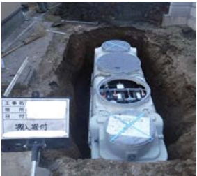
【合併処理浄化槽】
