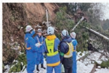
▲TEC-FORCEによる被災状況調査
