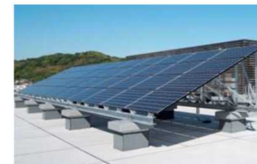
太陽光発電設備
