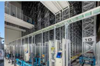
立体自動倉庫(岡山営業所)
