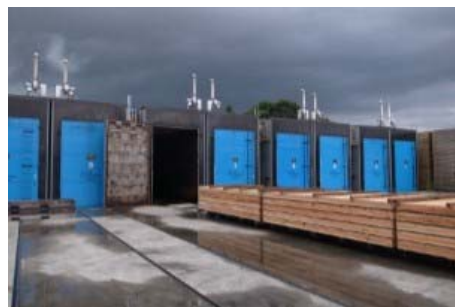
中核製材工場の乾燥施設
