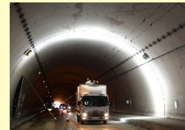
レーザー計測により、 背面空洞や内部損傷を確認
