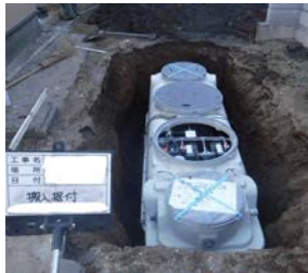
【合併処理浄化槽】
