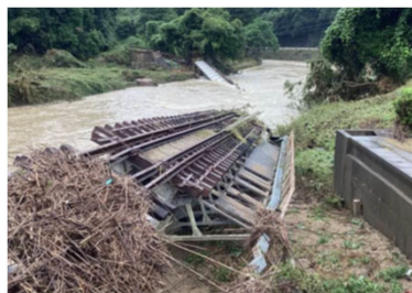
JR美祢線 橋梁倒壊 (令和5年梅雨前線による被害)
