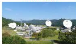
衛星通信システム の地上設備
