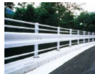
ガードレール
