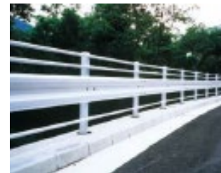
ガードレール
