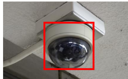
▲駅構内セキュリティカメラ(赤枠)
