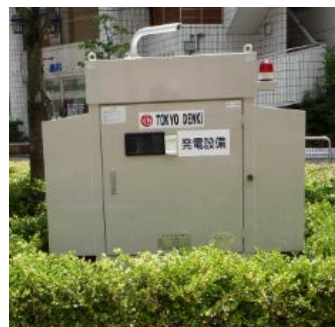
非常用発電機
