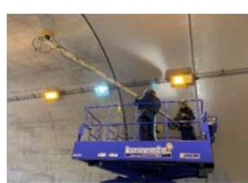
レーダーを利用したトンネル覆工の損傷把握
